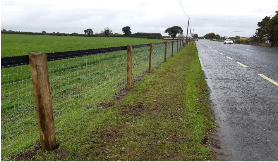
Gnáth-Oibreacha Athfheistithe Fálta a cuireadh i gcrích ar an N10 ag Dún Dá Radharc
